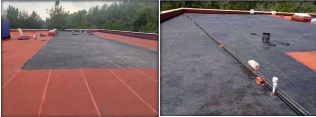
Ilustración 96. Mantenimiento a losa e instalación hidráulica de azotea de unidad tipo II de la Unidad de Tlahuitoltepec.
