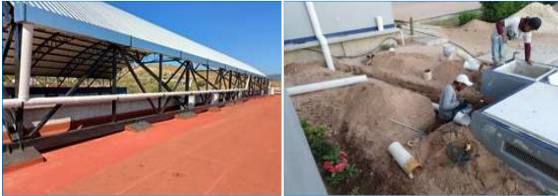
Ilustración 89. Elaboración y colocación de canalón pluvial a la cubierta de la plaza cívica, canalizando a las cisternas.
