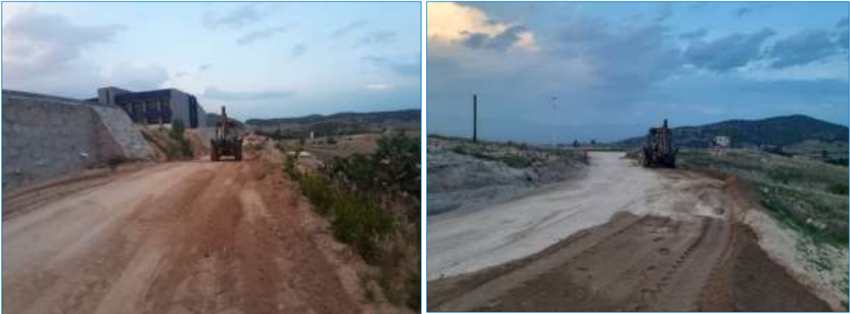
Ilustración 93. Rastreo del camino para con maquinaria pesada para la rehabilitación del acceso a la institución.
