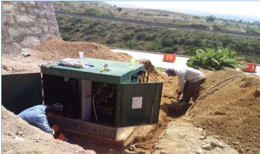
Ilustración 88. Mantenimiento preventivo a pastilla principal y transformador de 225 kva 3f-4h de la institución.
